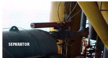
4 Gambar 1. Unit separator di instalasi lepas pantai Kepulauan seribu (CNOOC)
