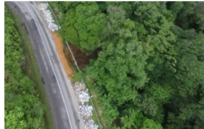
Gambar 4. Lokasi Longsor (sumber: dokumen proyek, 2017)
