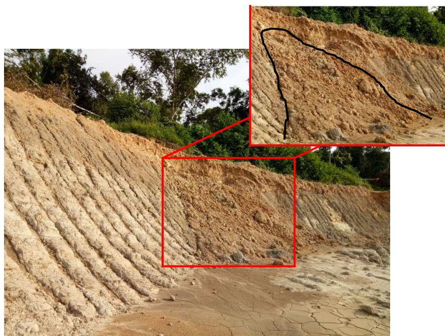
Gambar 1.1. Longsor busur pada lereng Pit Koto Buayo
