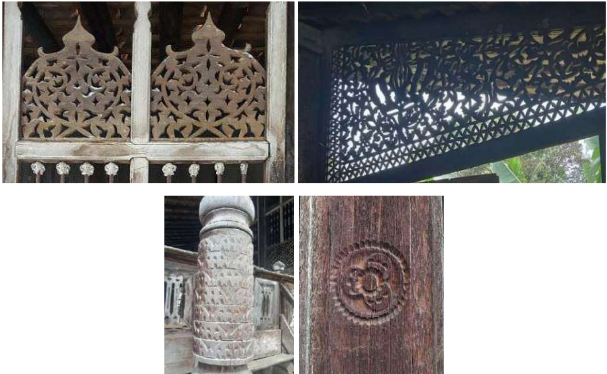
Gambar 20. Ornamen-ornamen pada Rumah “Bari” sumber: Tim Survei Lapangan Museum Negeri Sumatera Selatan (2022)
