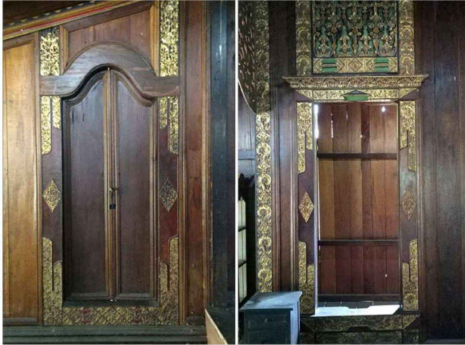
Foto 33 dan 34. Ukiran di bagian kusen pintu kamar (pangkeng). Ada juga ukiran di bagian atas pintu, berupa ukiran tembus yang berfungsi juga sebagai ventilasi.
