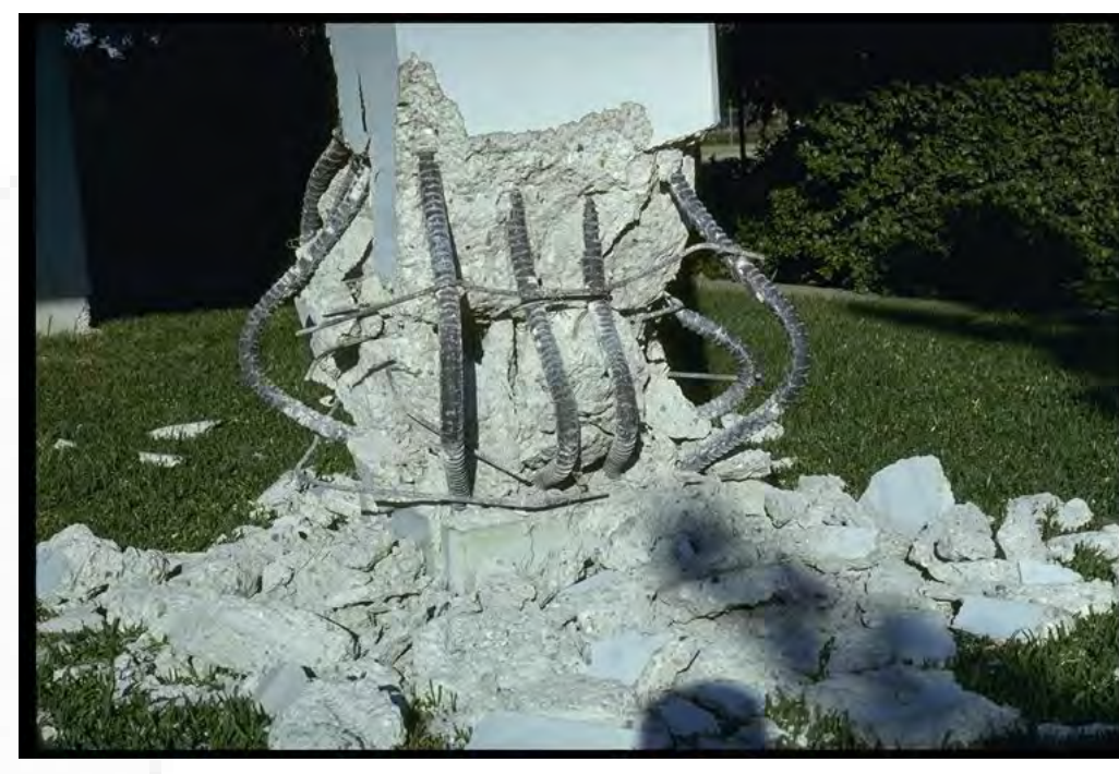
Tampak jarak dekat kegagalan di ujung bawah kolom bangunan Imperial County Services. Kegagalan terjadi pada zona kolom yang tidak memiliki tulangan sengkang (pengekang beton) yang cukup dan tidak ada tulangan geser.
