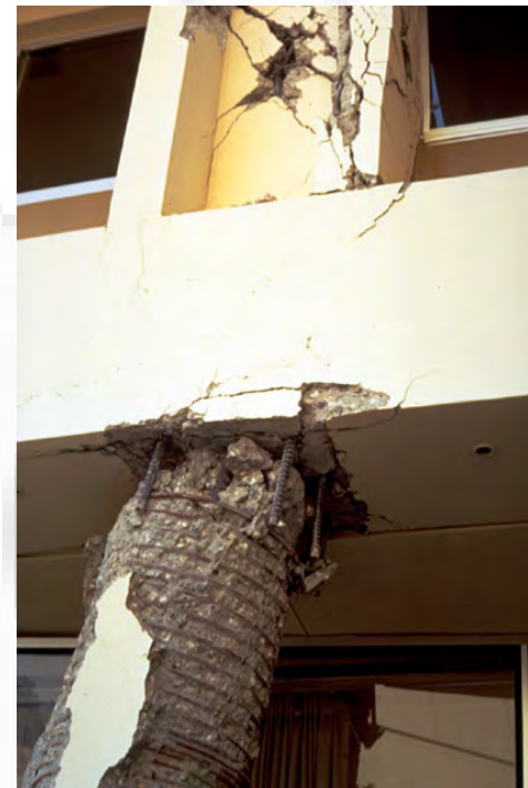
Olive View Hospital, gempa San Fernando tahun 1971. Tampak jarak dekat bagian atas kolom memperlihatkan beton di daerah kritis telah terganggu (pecah) akibat ujung tulangan sengkang spiral (pengekang beton) yang berhenti sebelum mencapai ujung kolom. Image credit: EIS-Godden
