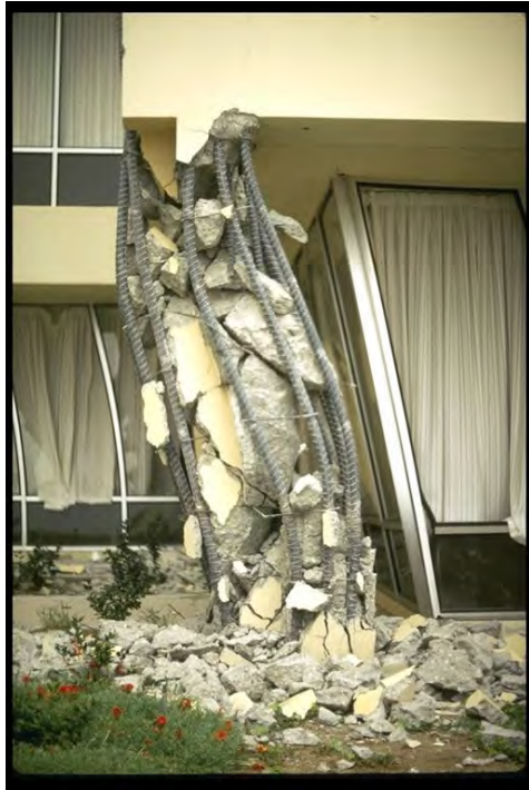
Kerusakan pada kolom Olive View Hospital akibat detail tulangan seismik (sengkang pengekan beton) kurang; gempa San Fernando Earthquake 1971.
