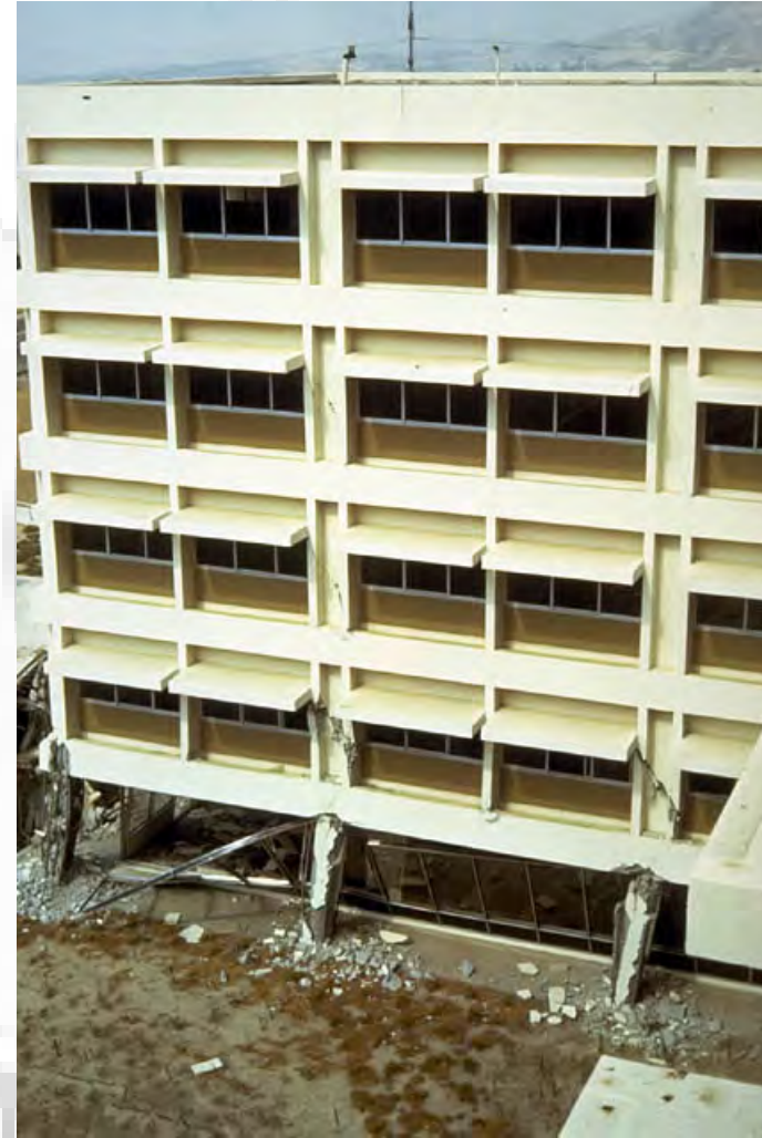
Olive View Hospital, Unit Penganan dan Perawatan Medis, gempa San Fernando, tahun 1971. Tampak ujung salah satu dari empat sayap bangunan beton bertulang 5 lantai setelah gempa. Sumber: db.world-housing.net
