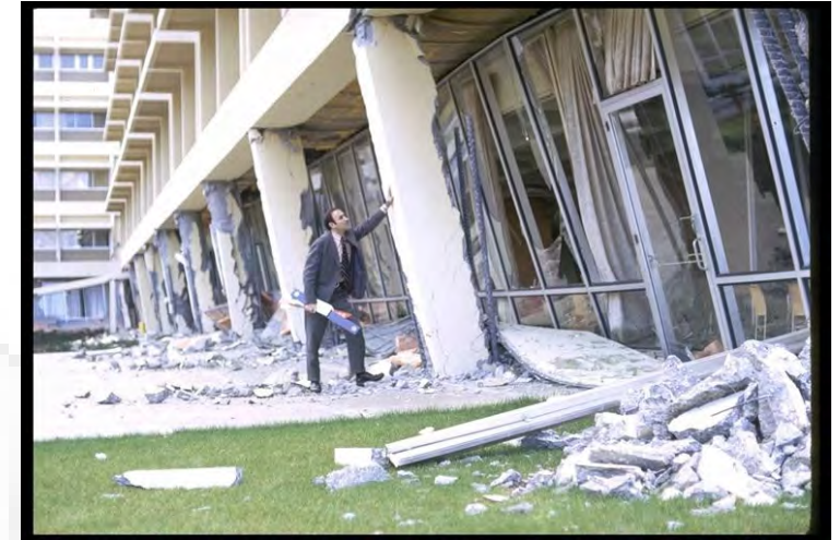
Kerusakan kolom-kolom yang merupakan bangunan rangka pemikul momen pada Olive View Hospital rusak akibat gempa San Fernando tahun 1971. Image credit: EIS-Steinbrugge
