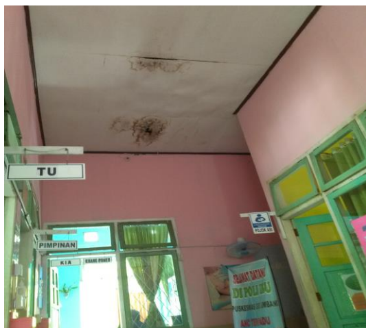
Gambar 1.3 Atap plapon yang rusak
