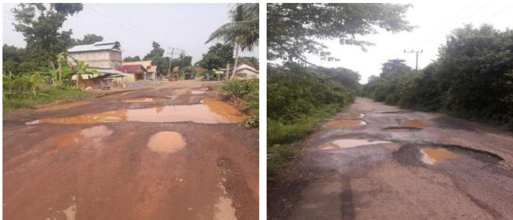
Gambar 1.1 Contoh Lobang Sepanjang Jalan Sirah Pulau Padang-Pampangan Sumber : Dinas Pekerjaan Umum dan Penataan Ruang Kabupaten OKI
