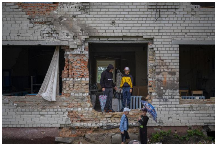
Gambar 1. 1 Kondisi Sekolah yang Hancur Akibat Perang di Desa Olyzarivka, Ukraina
