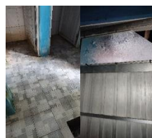
Gambar 4.41 Keadaan Gantungan dan Lantai Pada Ruangan Toilet Kedua
