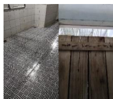
Gambar 4.40 Keadaan Gantungan dan Lantai Pada Ruangan Toilet Pertama
