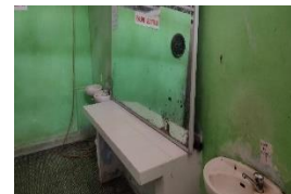
Gambar 4.30 Wastafel dan Kran Pada Ruang Toilet Pertama
