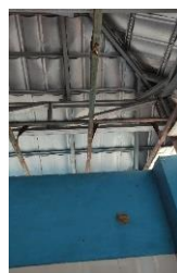
Gambar 4.32 Ventilasi Pada Ruang Toilet Kedua
