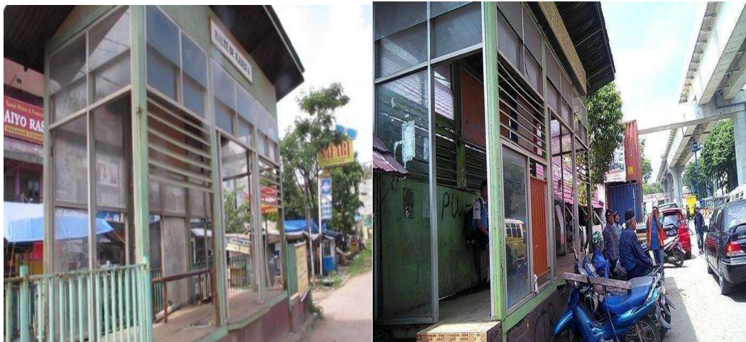
Gambar 1.5 Halte Yang Mengalami Kerusakan
