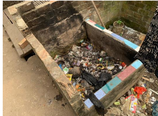
(Kondisi Sarana Pembuangan Sampah)
