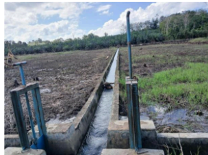
Gambar 6. Pintu Air Tersier di Lahan Sawah Desa Banyuasin Sumber: Dokumentasi Pribadi
