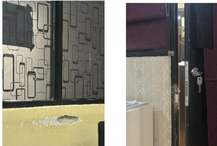
Gambar 1.1 Contoh kerusakan kantor
