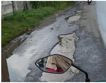
Gambar 1. 2 Kondisi Pertengahan Jalan
