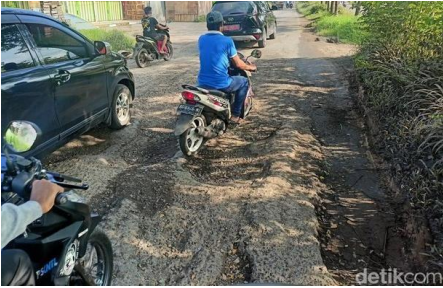
Gambar 1. 3 Kondisi Jalan di Pasar Induk
