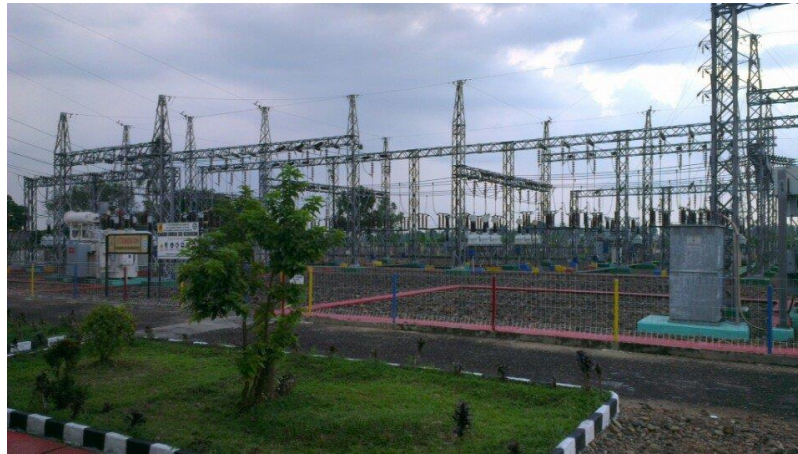
Gambar 3.1 Lokasi Gardu Induk Sungai Kedukan Palembang.
