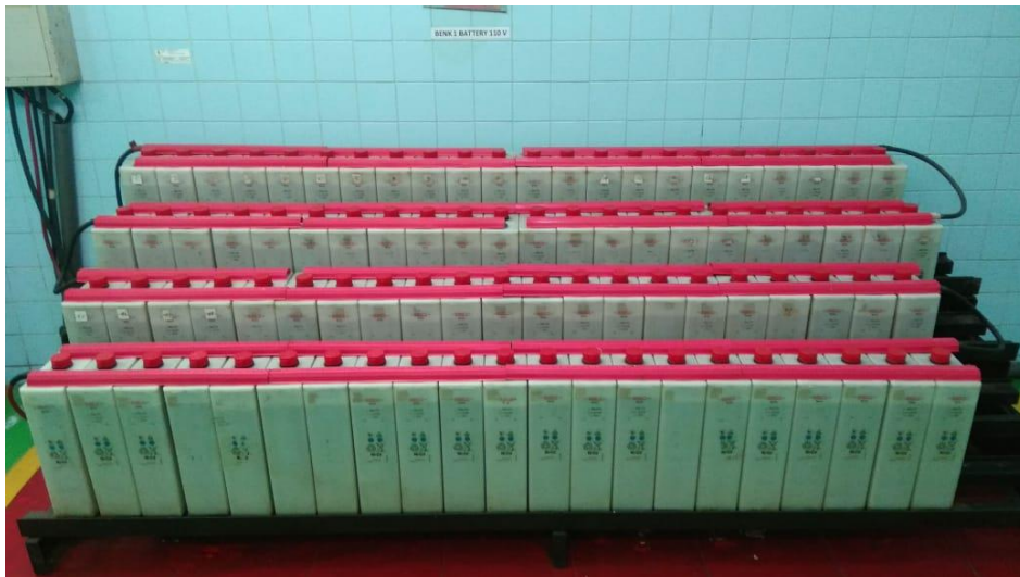
Gambar 2.2 Baterai 110 VDC Bank 1 Pada Gardu Induk 150 KV Sungai Kedukan Palembang.
