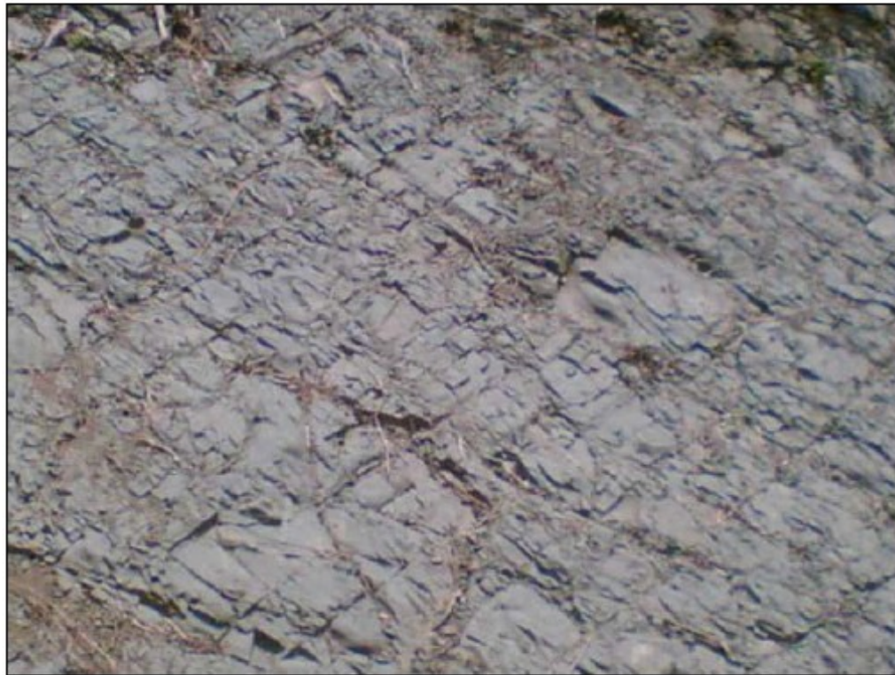
Gambar 3. Batulempung dengan struktur rekahan yang tersingkap.
