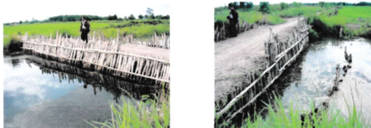
Gambar 7. Bangunan DAM di saluran Sekunder Drainase (SDU) delta Saleh.
