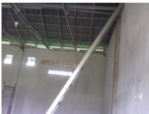
Sebagian kelas belum pasang plafon
