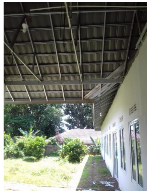
Pekerjaan plafon belum selesai
