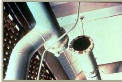
Gambar 3. Kerusakan sambungan pipa (sumber : FEMA E-74, 2012)
