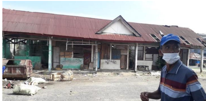
Gambar 1. Kondisi Pasar Ampera Kabupaten Bengkulu Selatan
