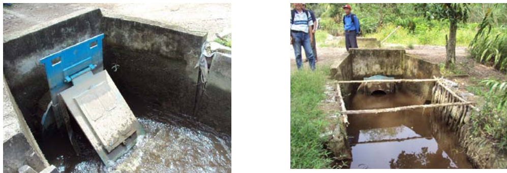
Gambar 43. Operasi Bangunan pengendali muka air sebagai pembuangan dan penahan air pasang di saluran tersier lahan tipe A Telang
