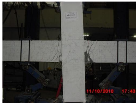
Gambar 6. Kondisi Benda Uji Join Balok Kolom di Akhir Pengujian (Sumber: Puslitbang Permukiman, 2010)
