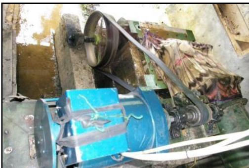
Gambar 13. Turbin Mikro hidro beda tinggi as turbin dengan Generator \pm 1 m
