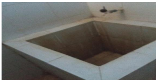
Gambar 1. Kondisi Kamar Mandi Deteni di Ruang Detensi Kantor Imigrasi Kelas I Palembang (Sumber: Dokumentasi Peneliti di Ruang Detensi Kantor Imigrasi Kelas I Palembang, 2017)
