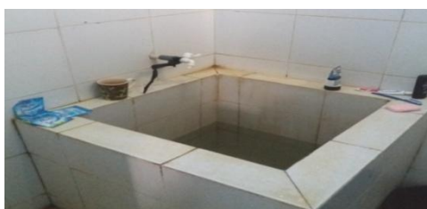
Gambar 2. Kondisi Kamar Mandi Deteni di Ruang Detensi Kantor Imigrasi Kelas I Palembang (Sumber: Dokumentasi Peneliti di Ruang Detensi Kantor Imigrasi Kelas I Palembang, 2017)
