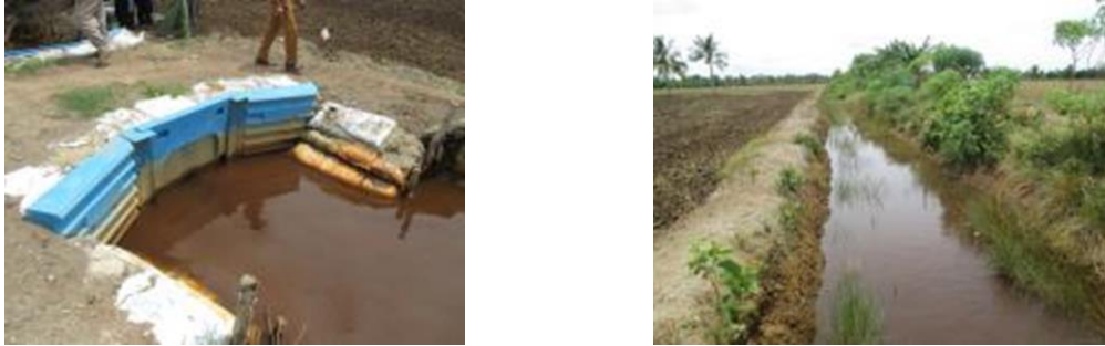
Gambar 4. Pintu tersier dalam posisi suplai dan saluran tersier berisi air
