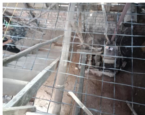
Tali plastik yang sudah terpasang
