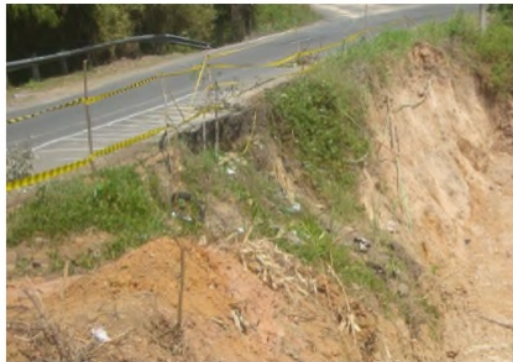
Gambar 1. Kondisi Jalan Jembatan Kikim Besar, KotaLahat Setelah Longsor (PT.Nusvey, 2015)
