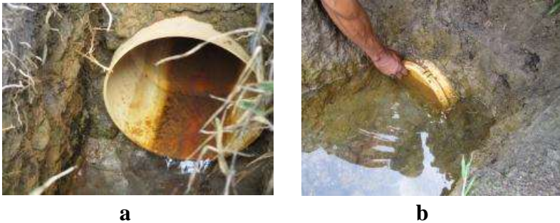
Gambar 5.6. Pipa paralon yang menghubungkan saluran kuarter ke saluran tersier (a) dan pintu kelep dari tutup kaleng cat bahan plastik (b) menghadap kearah saluran tersier.
