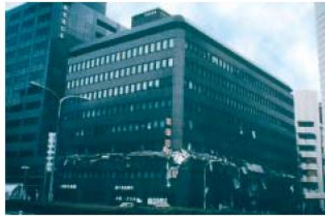
Gambar 2.9. Gempa Kobe 1995, bangunan komersial lantai ketiganya hilang dan lantai di atasnya mendudukinya (sumber : Bachmann 2003).
