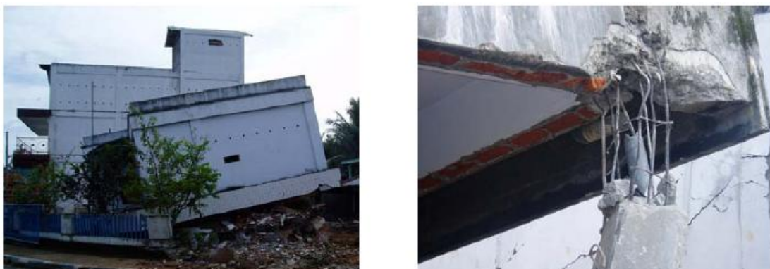
Gambar 2.6. Gempa Bengkulu 2007, pendetailan tulangan kolom yang tidak memadai dan kebiasaan memasukkan pipa saluran air hujan dalam kolom yang dapat mengurangi kapasitas geser kolom (sumber : Boen 2007a)
