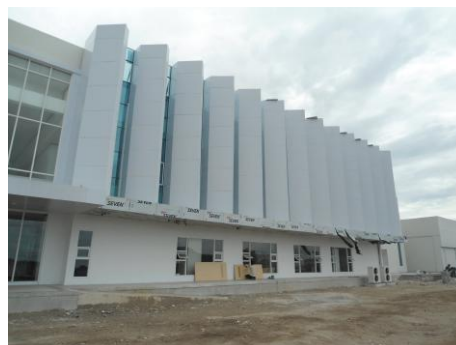
Gambar 2.39. Penggunaan sirip-sirip ACP sebagai ornamen hias pada bangunan (sumber : http://2.bp.blogspot.com/-gfa1bgpGJpE/UMG8HADqelI/AAAAAAAAAK4/BjW5U3Mg8yc/s1600/SIRIP+KANAN.JPG ).
