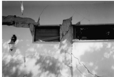
Gambar 8.13. Kegagalan geser short column akibat perletakan lubang ventilasi (sumber : Kozani, G (1996) dalam Penelis and Penelis (2014))
