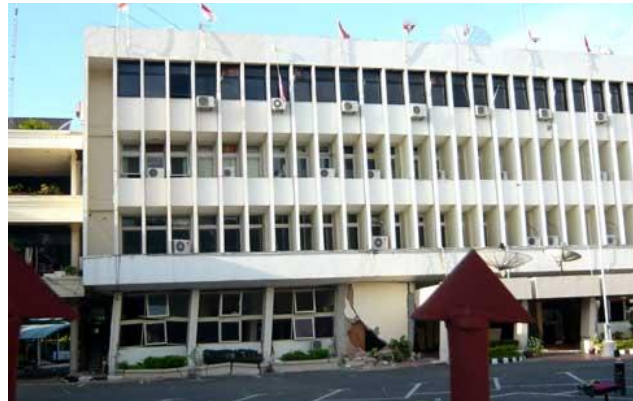
Gambar 2.40. Penggunaan sirip-sirip beton sebagai ornamen hias yang mempengaruhi kekakuan struktur utama bangunan (sumber : http://www.perencanaanstruktur.com/2010/10/bentuk-keruntuhan-bangunan-saat-gempa.html ).
