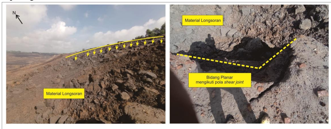
Gambar 1. 1 Longoran dengan tipe planar failure pada low wall Pit A.
