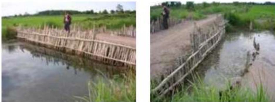
Gambar 6.9. Bangunan DAM di saluran Sekunder Drainase (SDU) delta Saleh.
