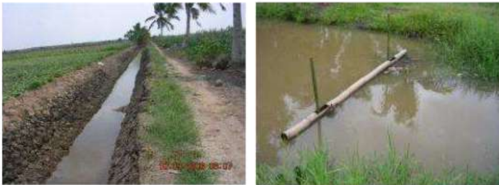
Gambar 5.1. Kondisi salura tersier (6a) dan inovasi penahan sampah (6b) didepan pintu tersier di rawa pasang surut
