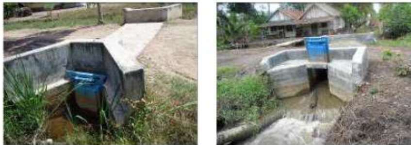
Gambar 4.1. Kondisi pintu tersier survai 2016 di desa Mulyasari Banyuasin
