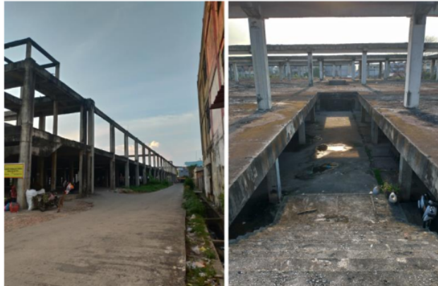
Gambar 2. 16 Kondisi struktur eksisting ( sumber: Dokumentasi Pribadi )
