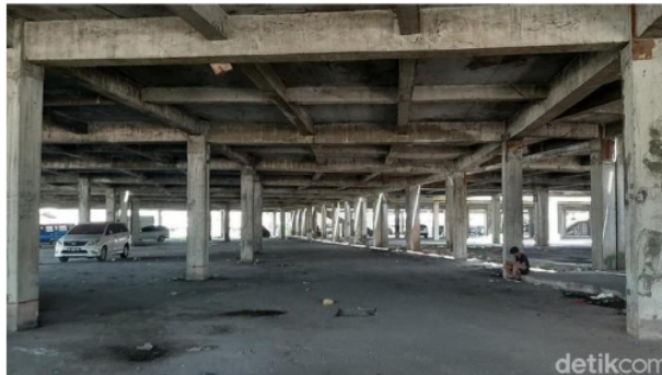
Gambar 2. 15 Kondisi struktur eksisting ( sumber: detik.com )
