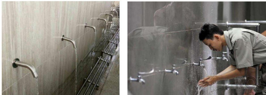
Gambar 4.1. Kran pada area wudhu
