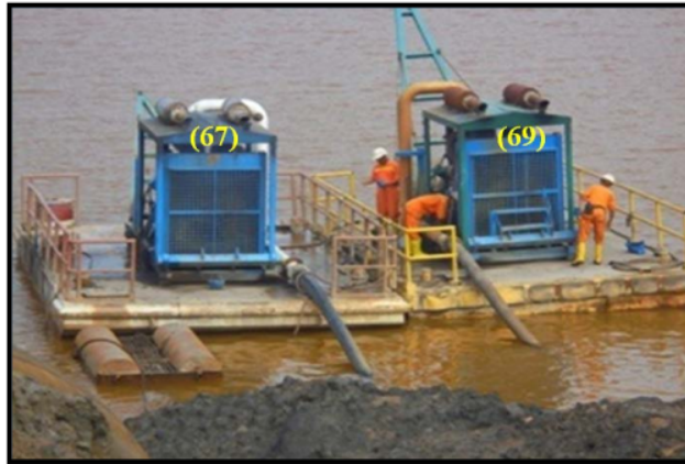
Gambar 2. Pompa Sulzer 385 kW (67) dan Sulzer 385 kW (69)
